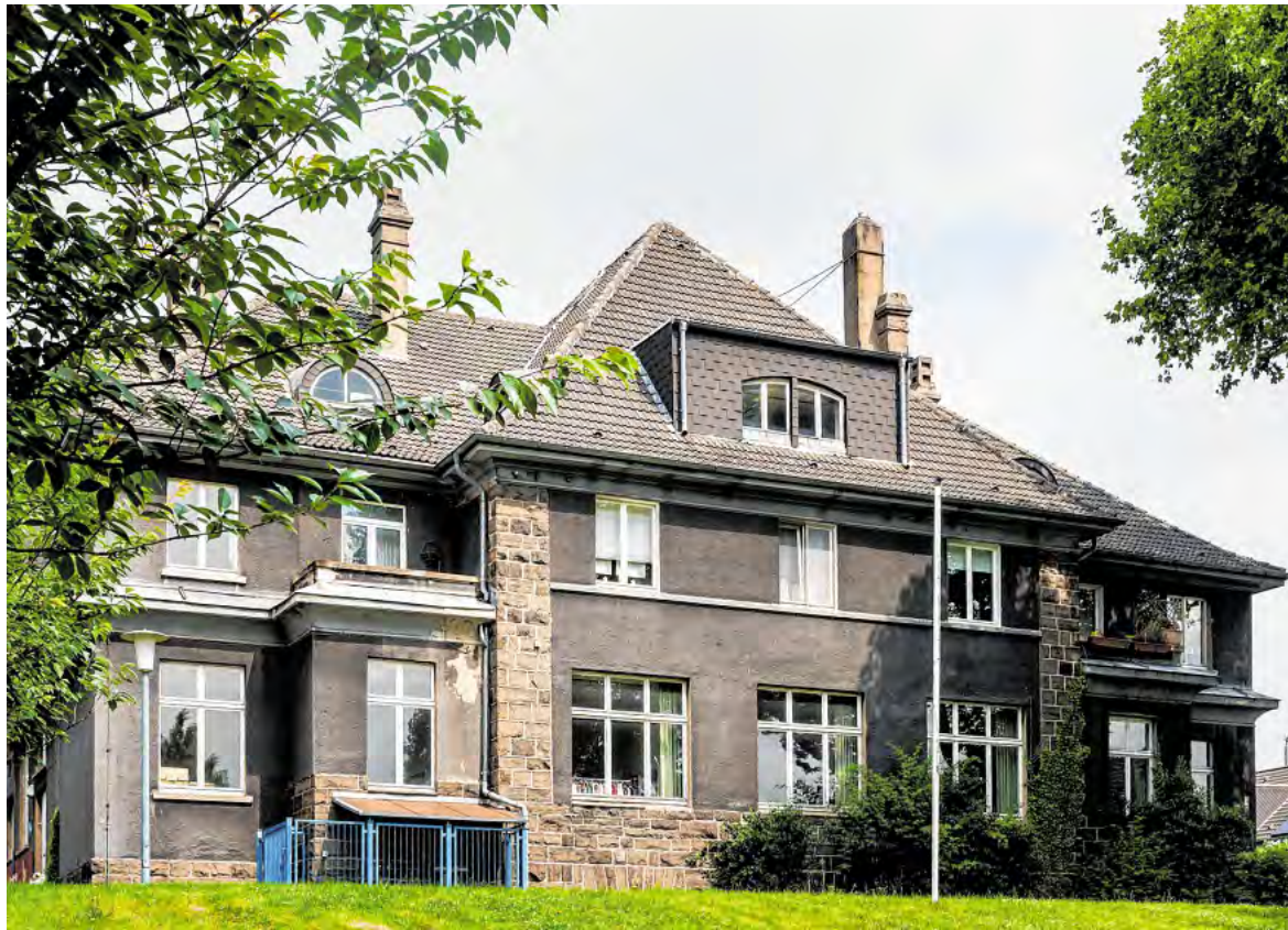
Müsste dringend und für viel Geld saniert werden: das Amtshaus Harpen.
